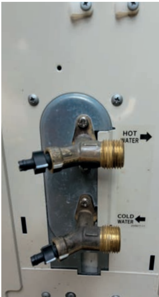
HOT WATER / COLD WATER aansluiting
